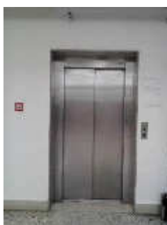
Ascensore zona Ala Nuova matr. N° 101-61 139
