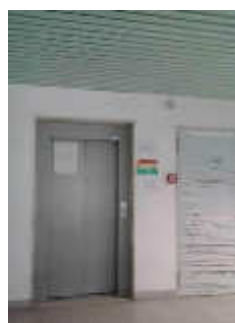
Ascensore zona Ala Nuova matr. N° 101-61 2
